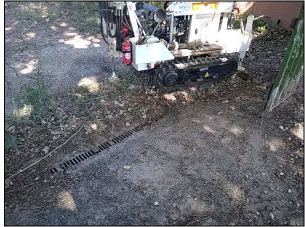
Vue de la grille de récupération des EP sur l'emprise du projet
